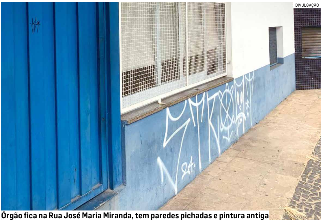
Órgão fica na Rua José Maria Miranda, tem paredes pichadas e pintura antiga
