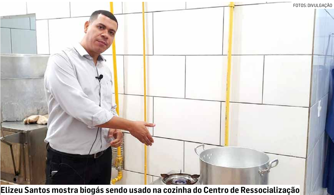
Elizeu Santos mostra biogás sendo usado na cozinha do Centro de Ressocialização
