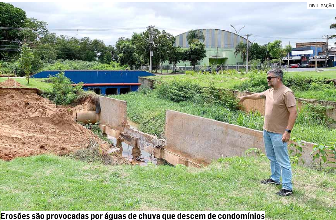
Erosões são provocadas por águas de chuva que descem de condomínios
