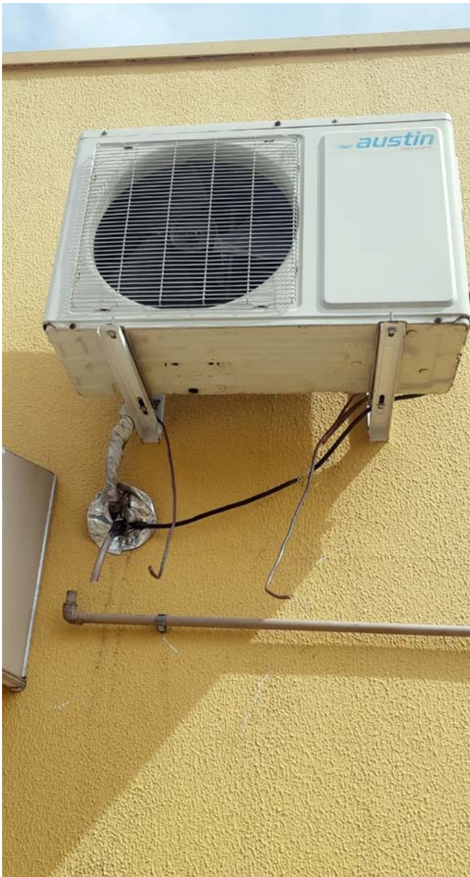
Roubo de fios do aparelho de ar condicionado
