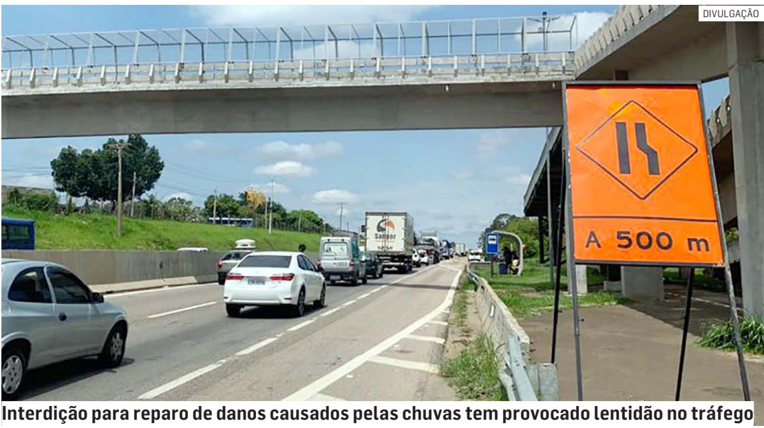
Interdição para reparo de danos causados pelas chuvas tem provocado lentidão no tráfego
